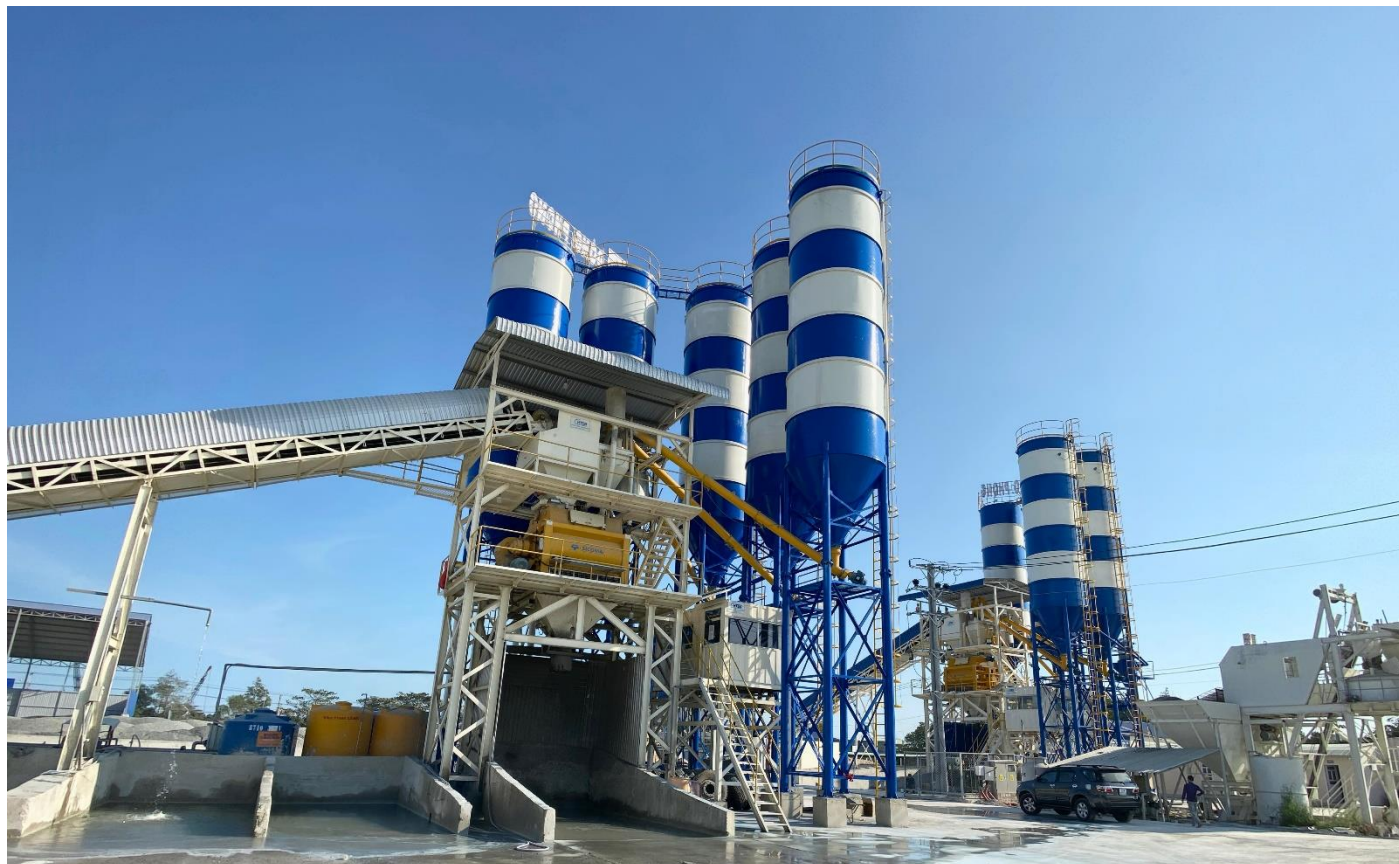
TRẠM TRỘN BÊ TÔNG 120M 3 /H (CONCRETE PLANT 120M 3 /H)
